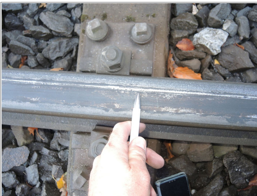
Obr. č. 8: Detailní pohled na rozježděný biologický materiál a na viditelnou stopu po smyku HDV 131.044-0/131.043-2 na temeni kolejnice TK č. 2.
