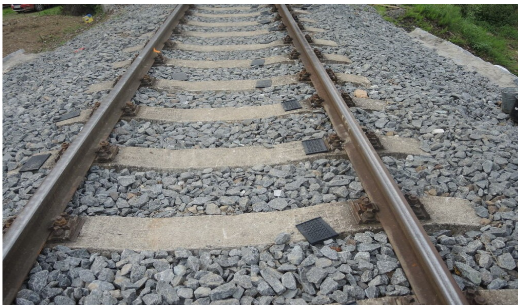
Obr. č. 2: Pohled na částečně povolené matice upevňovacích podložek před místem vzniku MU Zdroj: DI
