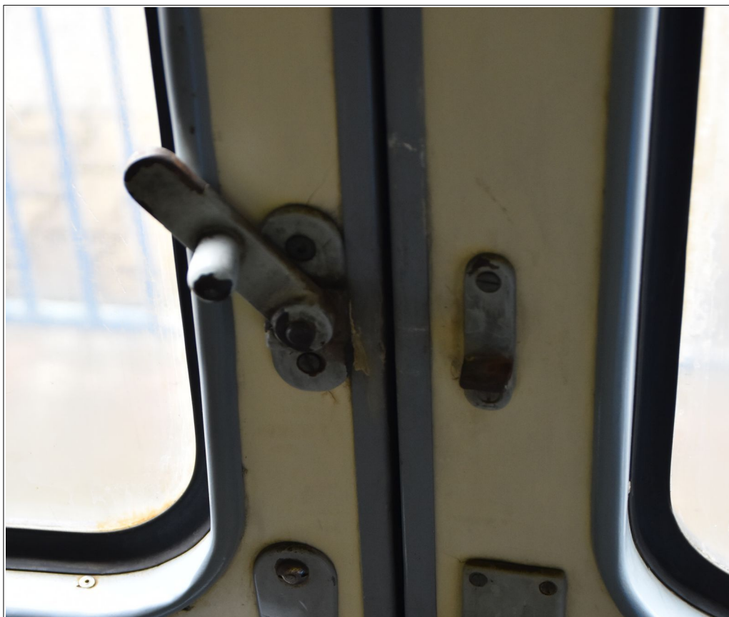
Obr. č. 7: Původní zajišťovací závora služebních dveří
