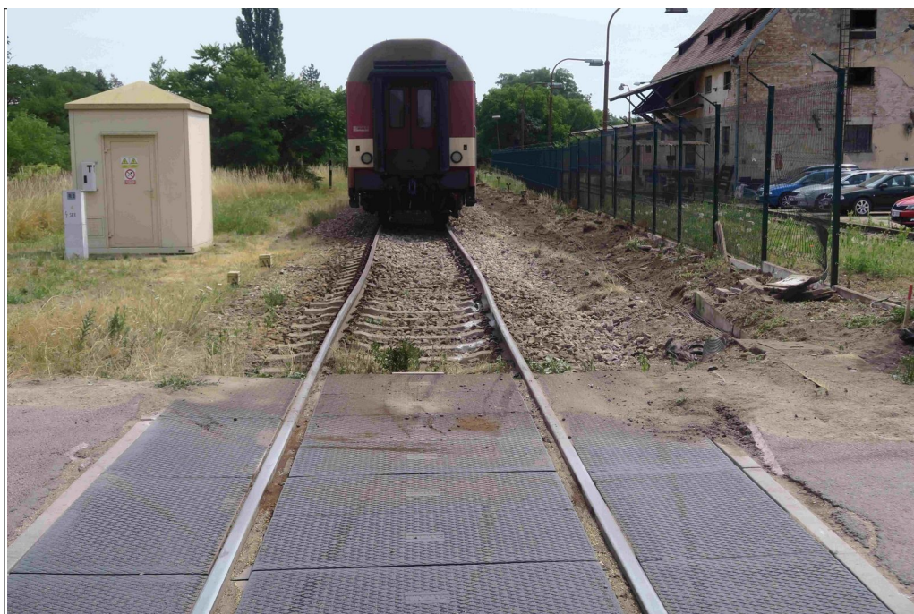
Obr. č. 8 Konec vlaku Os 4505, poškození trati po vykolejení
