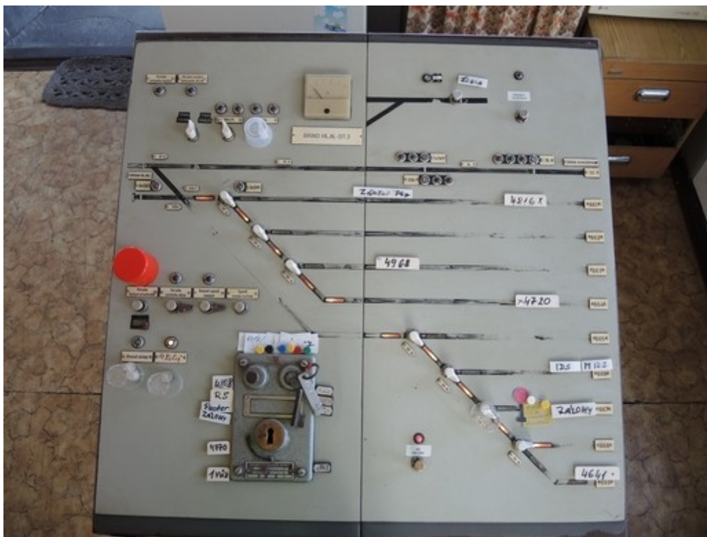
Obr. č. 3: Pohled na panel SZZ na St 3
