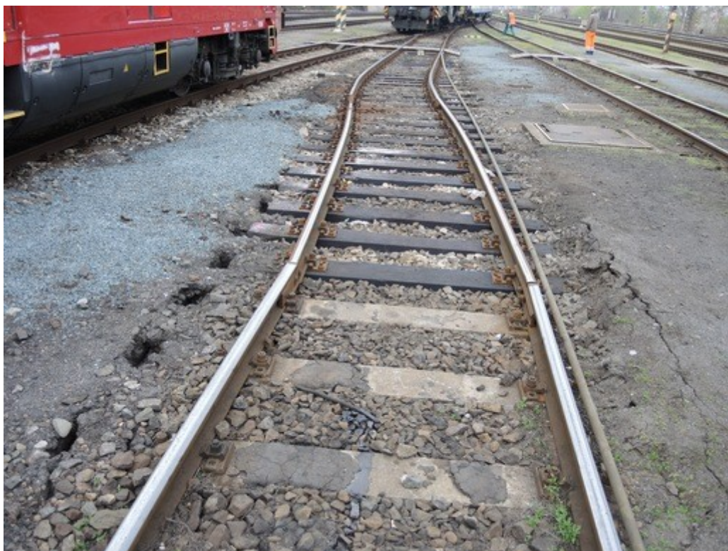
Obr. č. 7: Směrová deformace SK č. 663 po vykolejení
