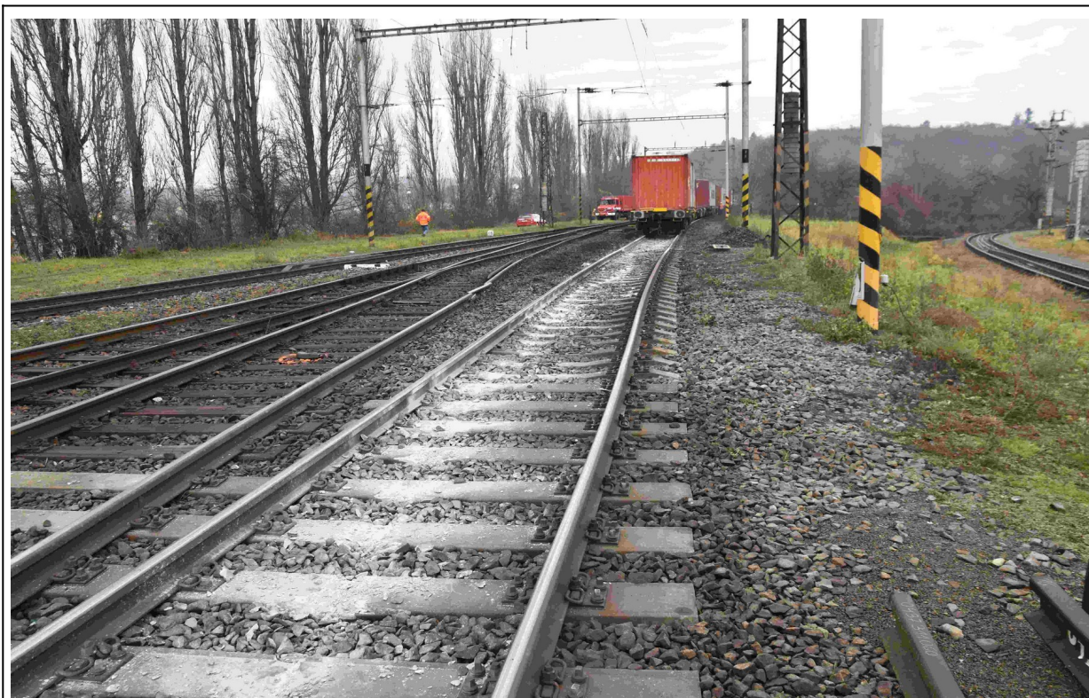
Obr. č. 3: Poškození traťového svršku za výhybkou č. 48b po odvezení nevykolejených vozů Zdroj: DI
