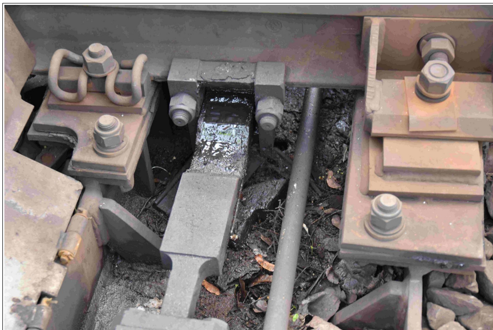
Obr. č. 10: Nálezový stav odlomené části háku výhybky č. 48a v žst. Brno-Maloměřice Zdroj: DI
