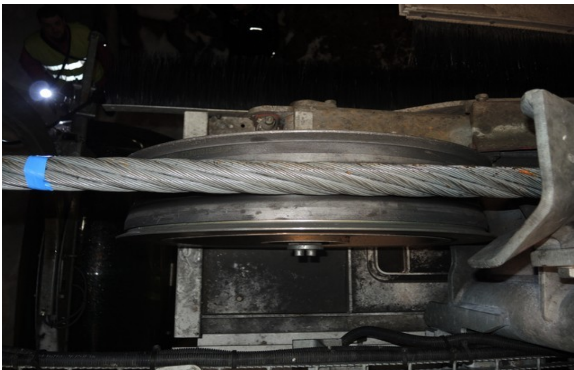
Obr. č. 6: Poškrábané dopravní lano před závěsem sedačky č. 30
