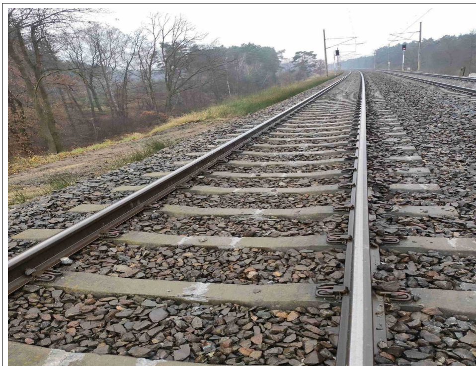
Obr. č. 7: Pohled na poničenou infrastrukturu
