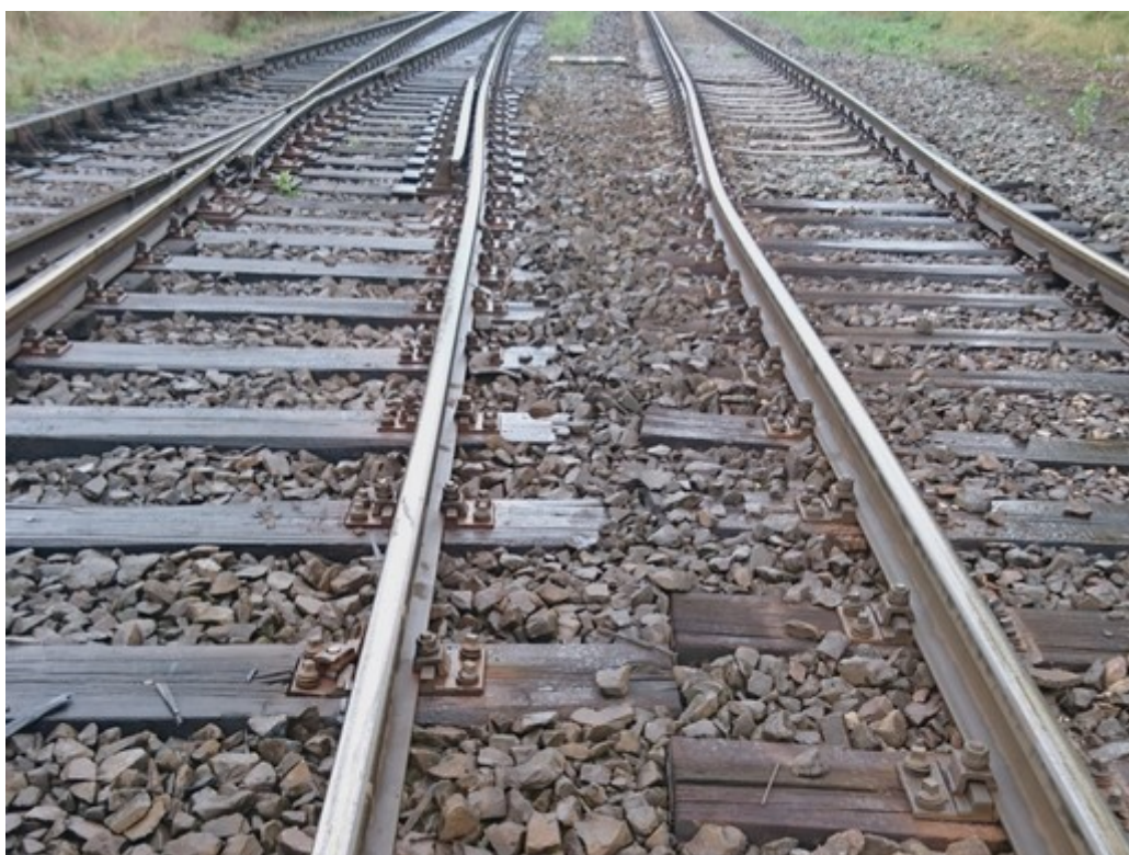
Obr. č. 6: Poškozený svršek v důsledku vykolejení vlaku
