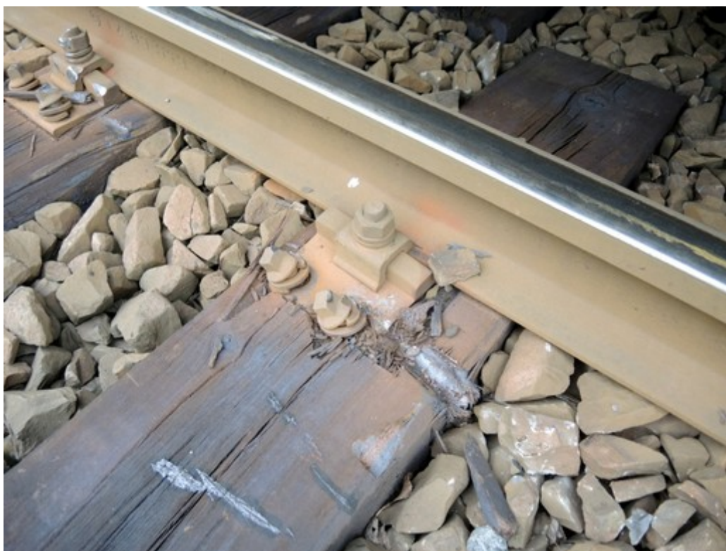
Obr. č. 5: Poškozený svršek v důsledku vykolejení vlaku
