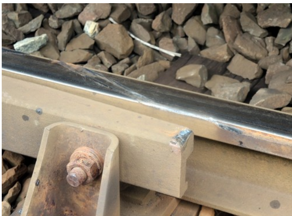
Obr. č. 4: Stopy po přestoupaní DV přes temeno kolejnice
