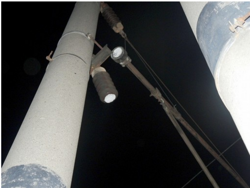
Obr. č. 5: Prasklý izolátor na stožáru
