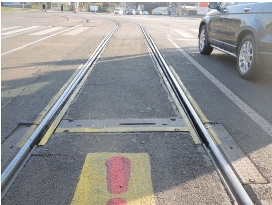
Obr. č. 3: Výhybka č. 709, stav po MU
