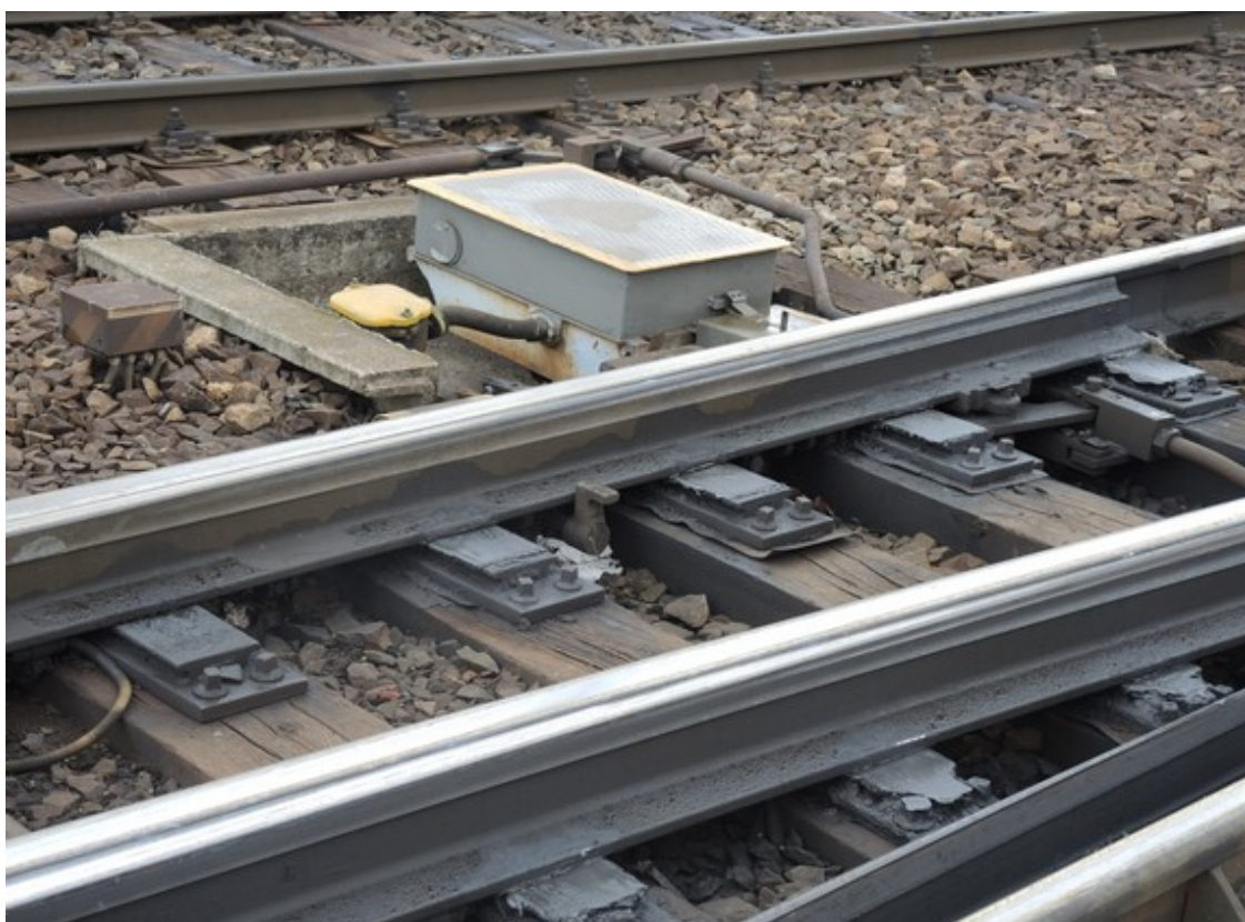
Obr. č. 7: Výměnový zámek na výhybce č. 11a
