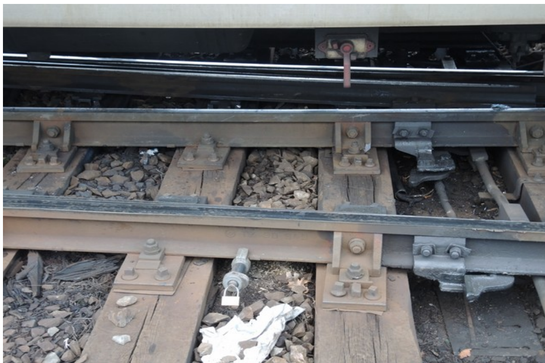
Obr. č. 6: Uzamčený ambulanti zámek na výhybce č. 13b
