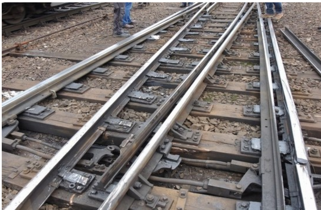
Obr. č. 8: Výhybka č. 13b s chybějícím jazykem (uprostřed vlevo)
