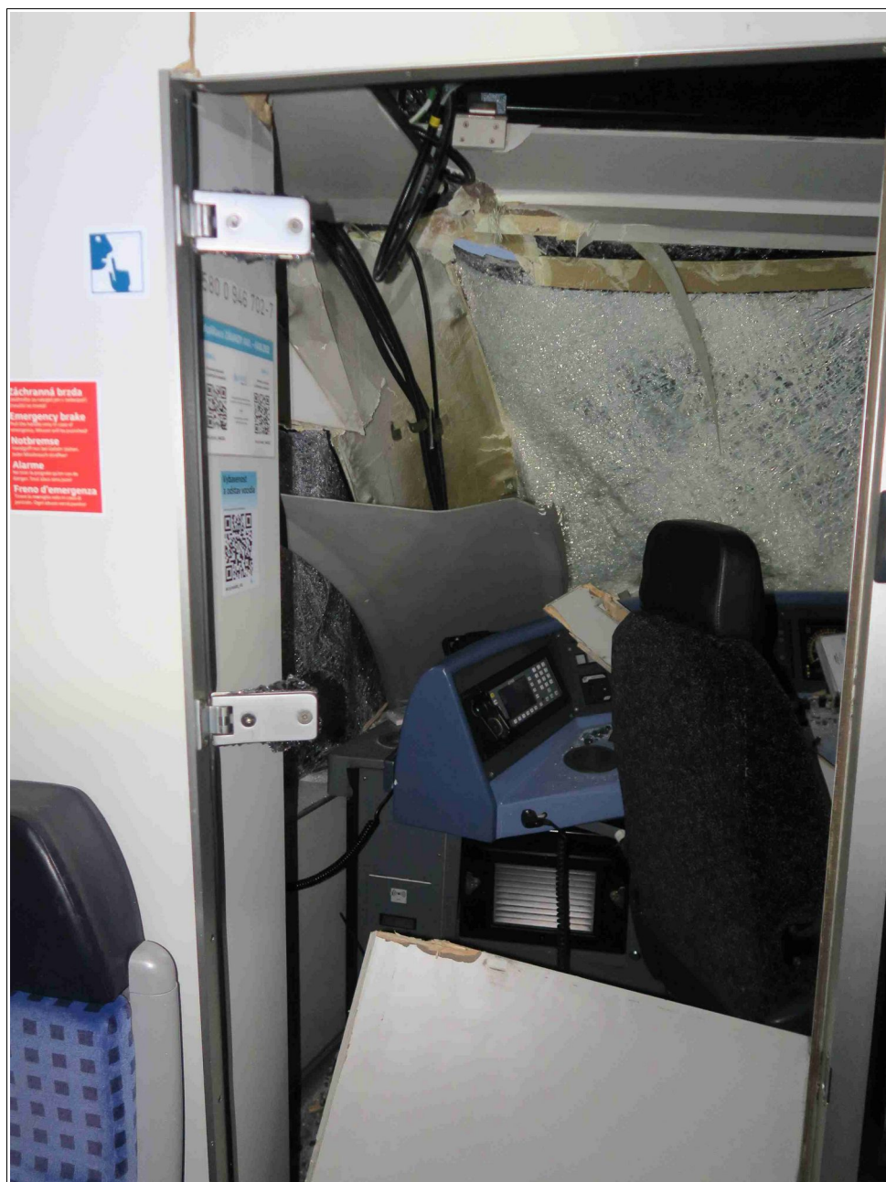
Obr. č. 6: Pohled do kabiny strojvedoucího z oddílu pro cestující skrze rozbité dveře kabiny strojvedoucího KŘV-B 948.702-6. Zdroj: DI
