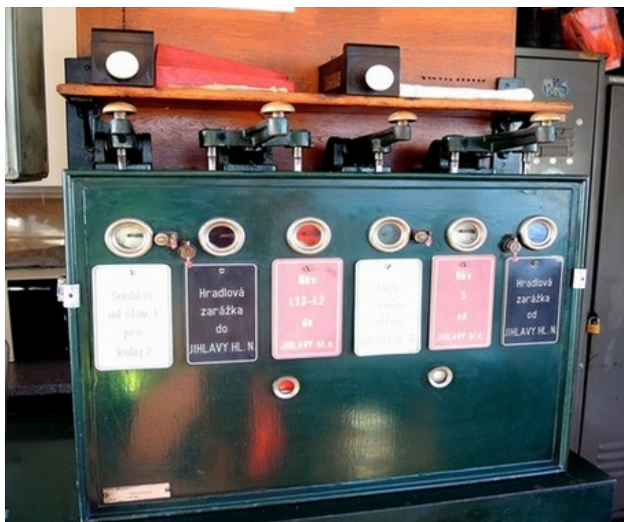
Obr. č. 6: Stav hradlové části stavědlového přístroje na St. 2 po MU
