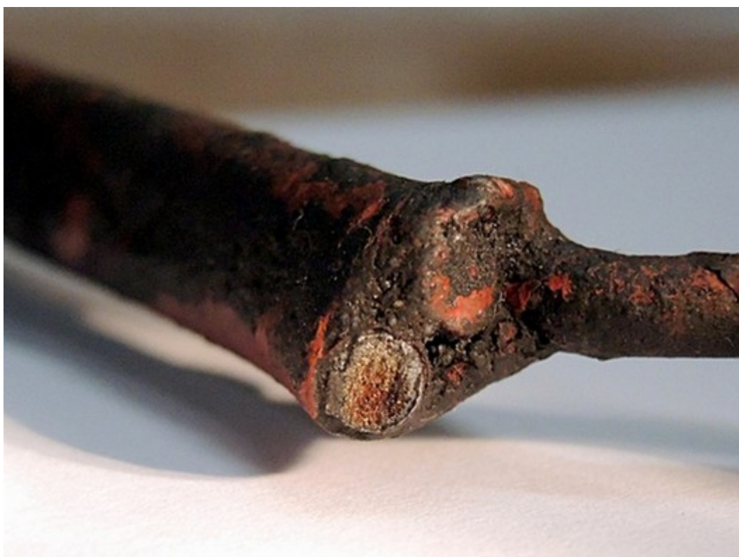
Obr. č. 8: Detail lomové plochy přetrženého drátovodu - 1
