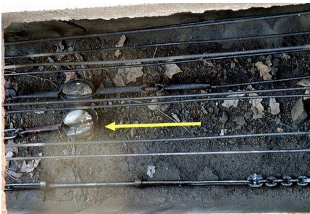
Obr. č. 1: Volně ležící keramická izolační vložka po přetržení drátovodu výhybky č. 34
