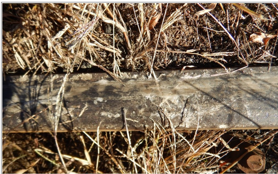
Obr. č. 3: Detail stavu temene hlavy kolejnicového pásu SK č. 2
