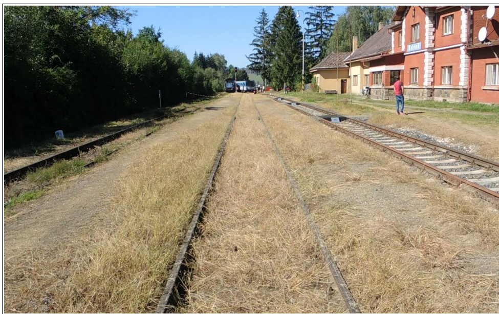
Obr. č. 5: Pohled na SK č. 2 žst. Kdyně
