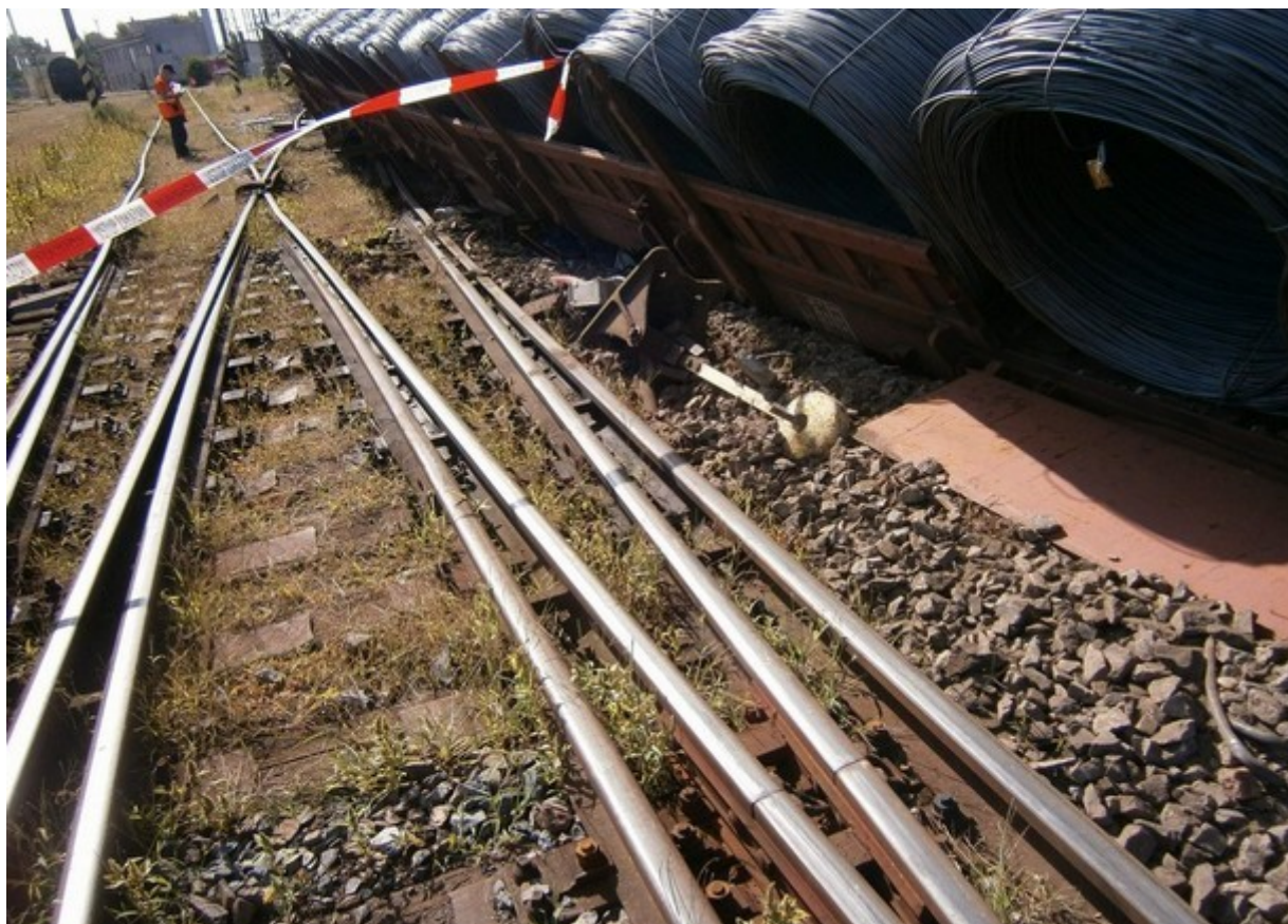
Obr. č. 15: Poškození výhybky č.44a/b.
