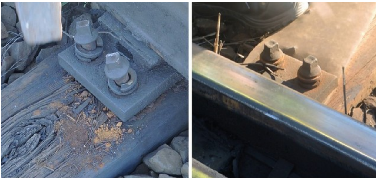
Obr. č. 11: Stav vrtulí levého pasu mezi body „+3“ a „+4“ uvnitř a vně koleje. Zdroj: videozáznam DI
