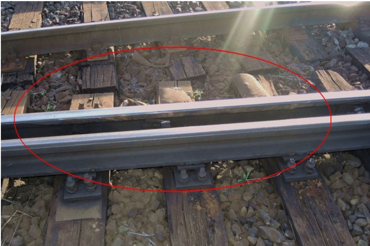
Obr. č. 3: Stopa na levé opornici výh. č. 38 po propadu kola v úrovni 8. pražce, stav vrtulí. Zdroj: SŽDC
