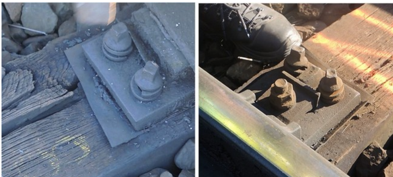
Obr. č. 7: Stav vrtulí levého pasu v bodě „+1“ uvnitř a vně koleje.
