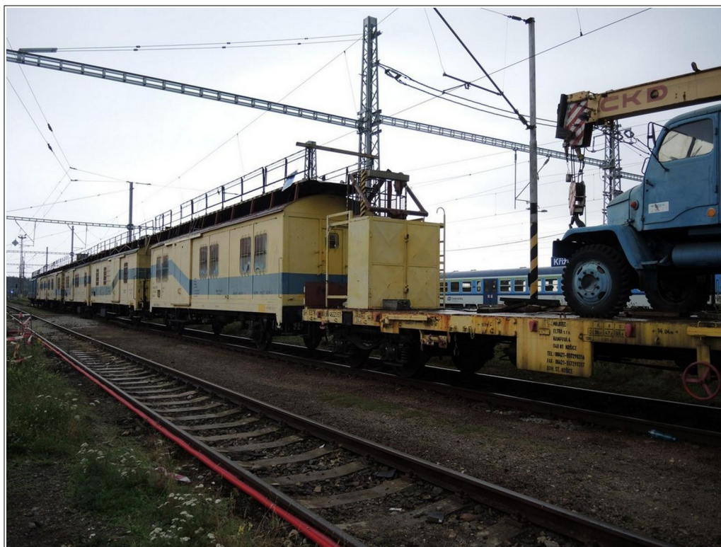
Obr. č. 6: Zadní část VTV po stažení na 4. SK
