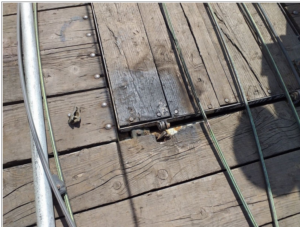
Obr. č. 7: Stopy po zásahu zkratovým proudem na plošině DV
