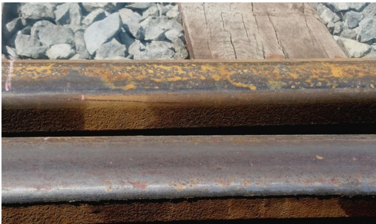
Obr. č. 4: Stopa sjetí kola prvního dvojkolí vlaku Os 8532 z levé ohnuté opornice výhybky č. 1sv – bod „0“.
