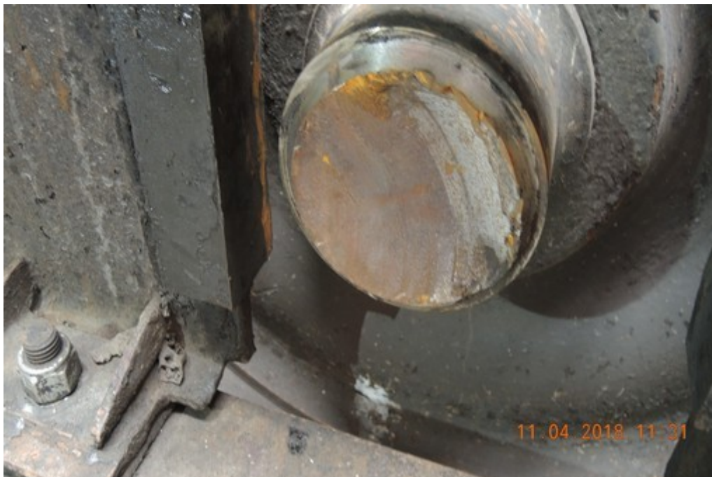
Obr. č. 7: Pohled na zbylou část ulomeného čepu
