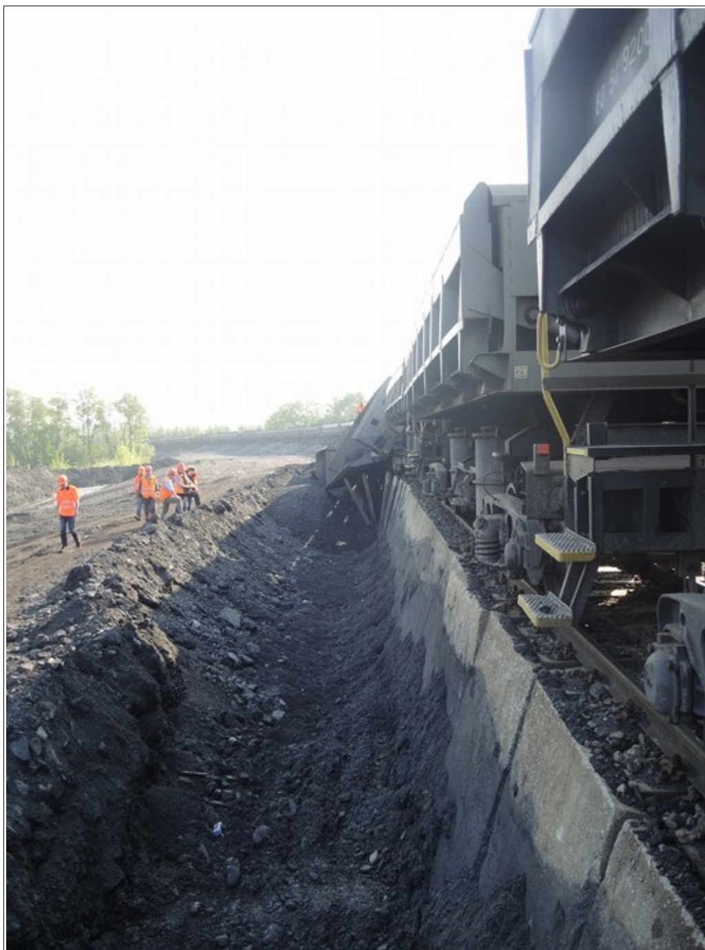
Obr. č. 4: Pohled do odebrané jámy vykládkové rampy od 1. silničního panelu.
