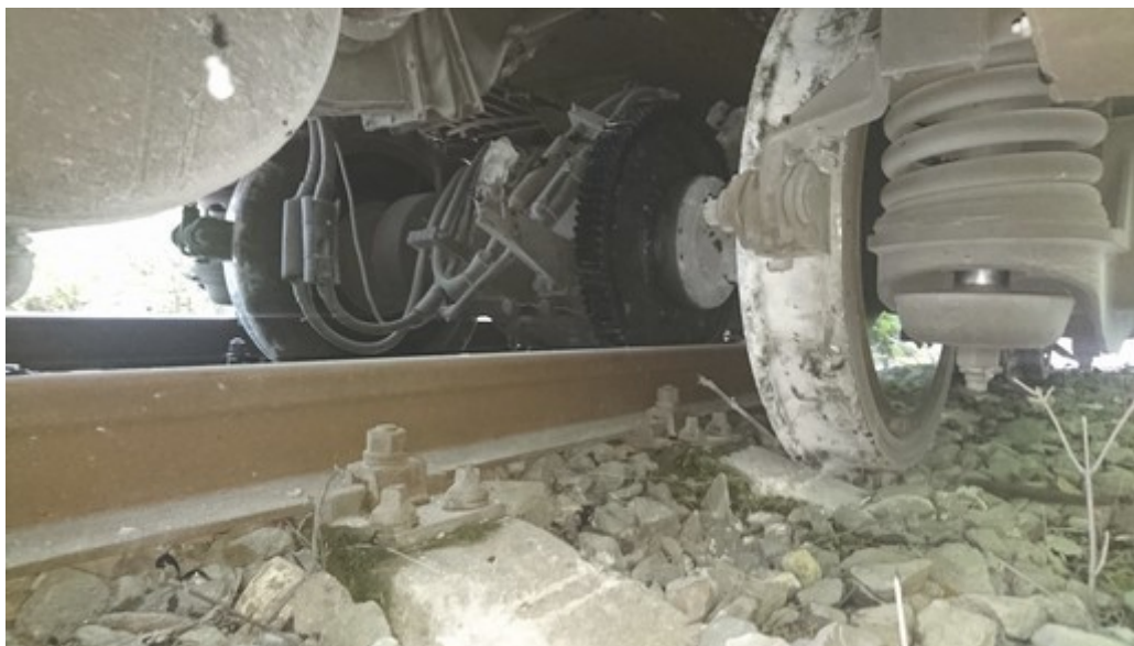
Obr. č. 5: Odhalený převod trakčního motoru HDV, vykolejený podvozek Zdroj: DI
