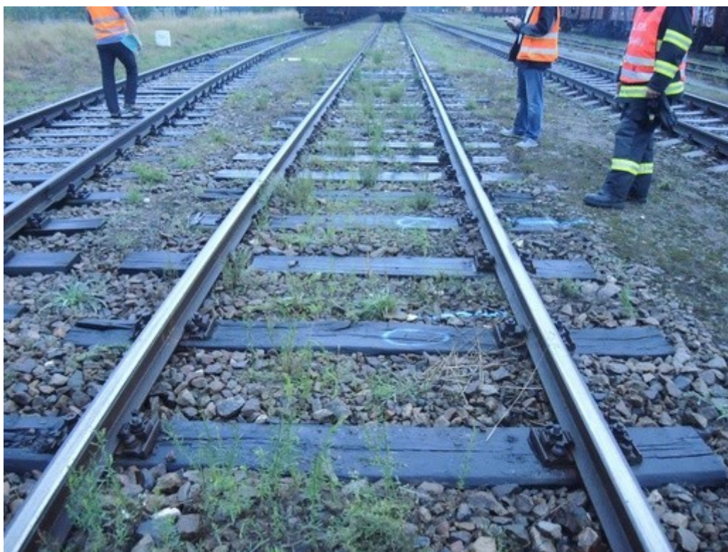
Obr. č. 7: Bod „0“, místo vykolejení, propadu pravých kol 2. TDV dovnitř 3. SK
