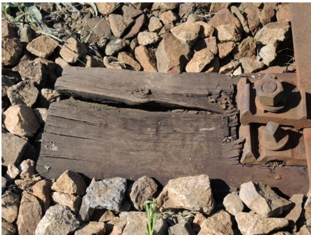
Obr. č. 9: Ukázka stavu vnějšího upevnění levé kolejnice – posun podkladnice po pražci a vyskočená svěrka (1. pražec před bodem „0“)
