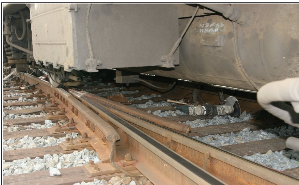
Foto 2: Srdcovka výhybky č. 89
