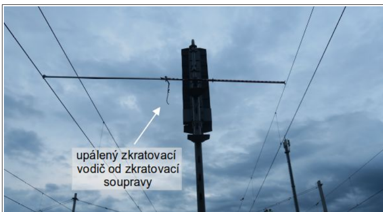
Obr. č. 3: Pohled na zkratovací soupravu umístěnou na stožáru odjezdového návěstidla L3a žst. Otrokovice a na její upálené zkratovací lano Zdroj: SŽ
