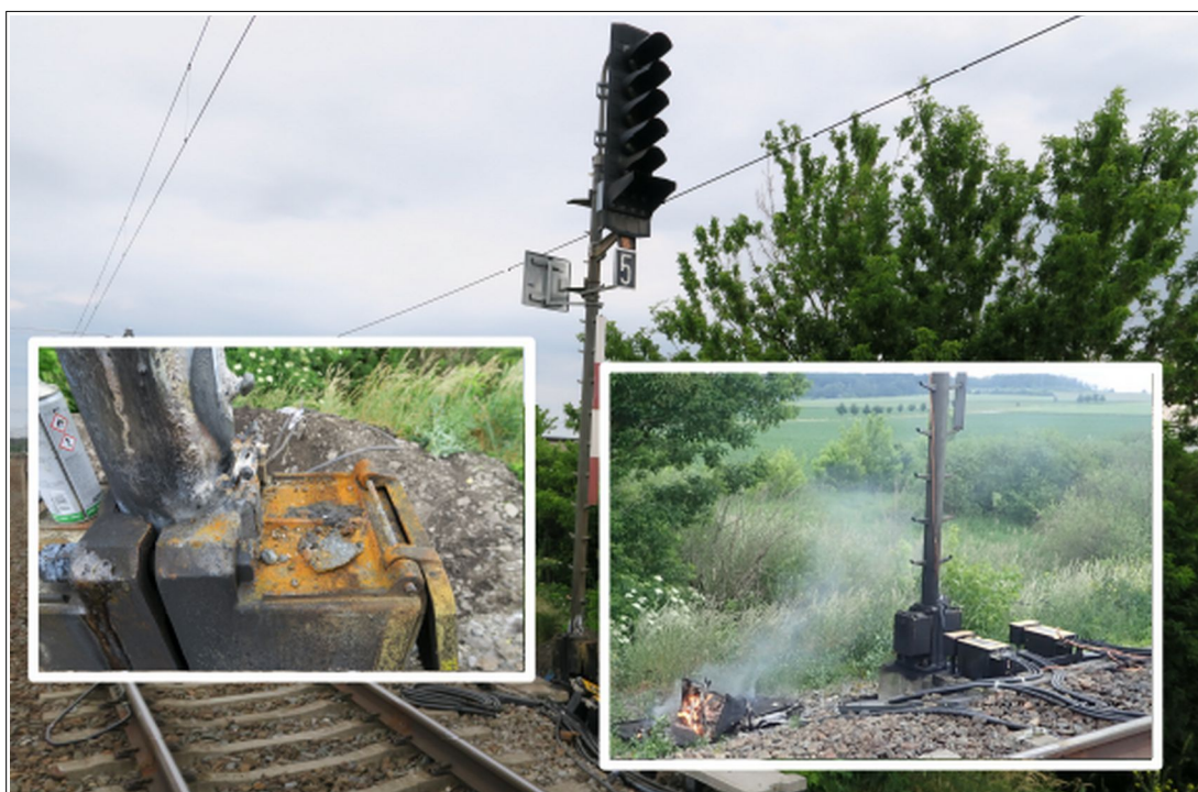
Obr. č. 14: Pohled na vjezdové návěstidlo 1S žst. Tlumačov. Levý snímek ve výřezu dokumentuje stopy přitavení zkratovacího lana zkratovací soupravy ke stožáru vjezdového návěstidla a pravý snímek ve výřezu dokumentuje požár kabelové skříně SKP a zavěšení a svedení lana zkratovací soupravy po stožáru vjezdového návěstidla.
