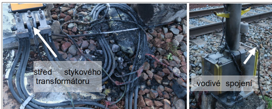
Obr. č. 4: Pohled na propojení lana zkratovací soupravy se středem stykového transformátoru 3aKN (levý snímek) a vodivé spojení mezi průrazkou odjezdového návěstidla L3a žst. Otrokovice a kolejnicí SK č. 3a (pravý snímek) Zdroj: SŽ
