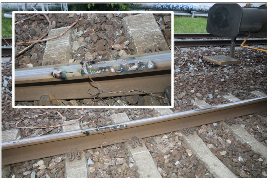
Obr. č. 17: Pohled na levou kolejnici napjedelského záhlaví žst. Otrokovice (v prostoru TP č. 73), která je pokračování TK č. 1 Napajedla – Otrokovice, po vzniku MU. Snímek ve výřezu dokumentuje detailní stav této kolejnice po natavení stržené části TV. Zdroj: SŽ
