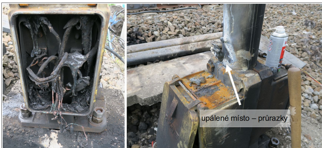
Obr. č. 6: Pohled na poškozenou rozvaděčovou skříňku vjezdového návěstidla 1S žst. Tlumačov (levý snímek) a upálené torzo průrazky umístěné na stožáru vjezdového návěstidla (pravý snímek) Zdroj: DI
