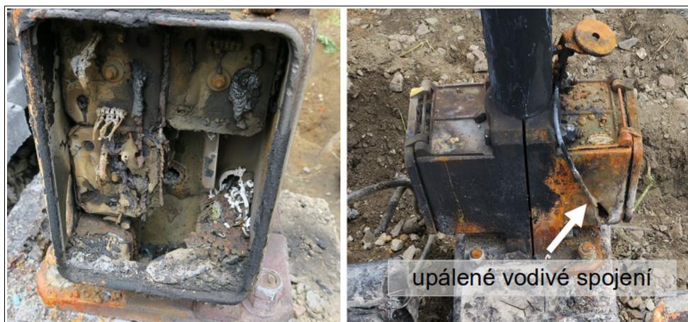
Obr. č. 5: Pohled na poškozenou rozvaděčovou skříňku oddílového návěstidla AB 1-1564 (levý snímek) a poškozenou průrazku a upálené vodivé spojení s kolejnicí TK (pravý snímek) Zdroj:DI
