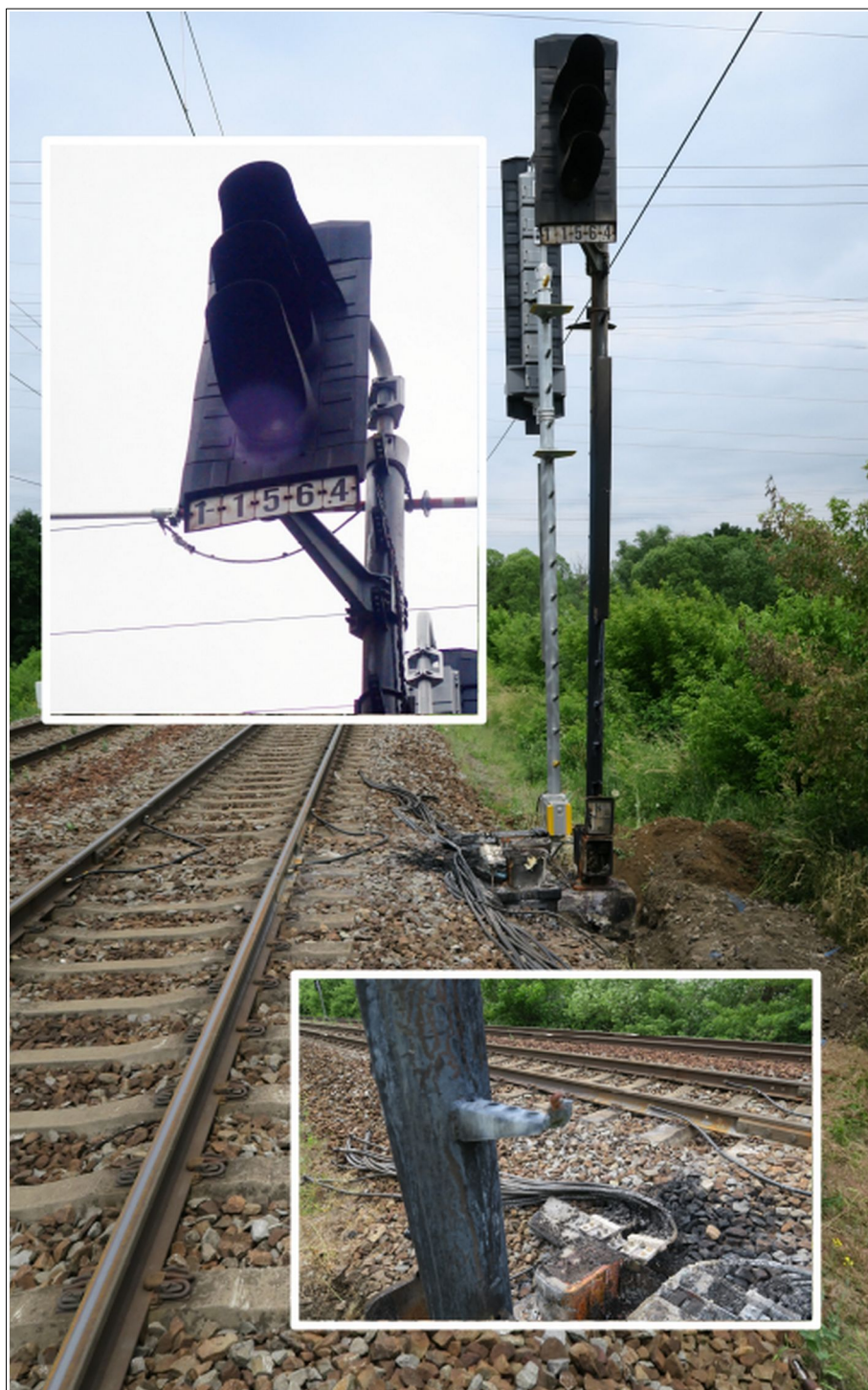
Obr. č. 13: Pohled na oddílové návěstidlo AB 1-1564 TÚ Otrokovice – Tlumačov. Horní snímek ve výřezu dokumentuje umístění zkratovací soupravy, vč. vedení zkratovacího lana po stožáru návěstidla, a dolní snímek ve výřezu dokumentuje stopy přitavení zkratovacího lana zkratovací soupravy ke stupačce stožáru návěstidla.
