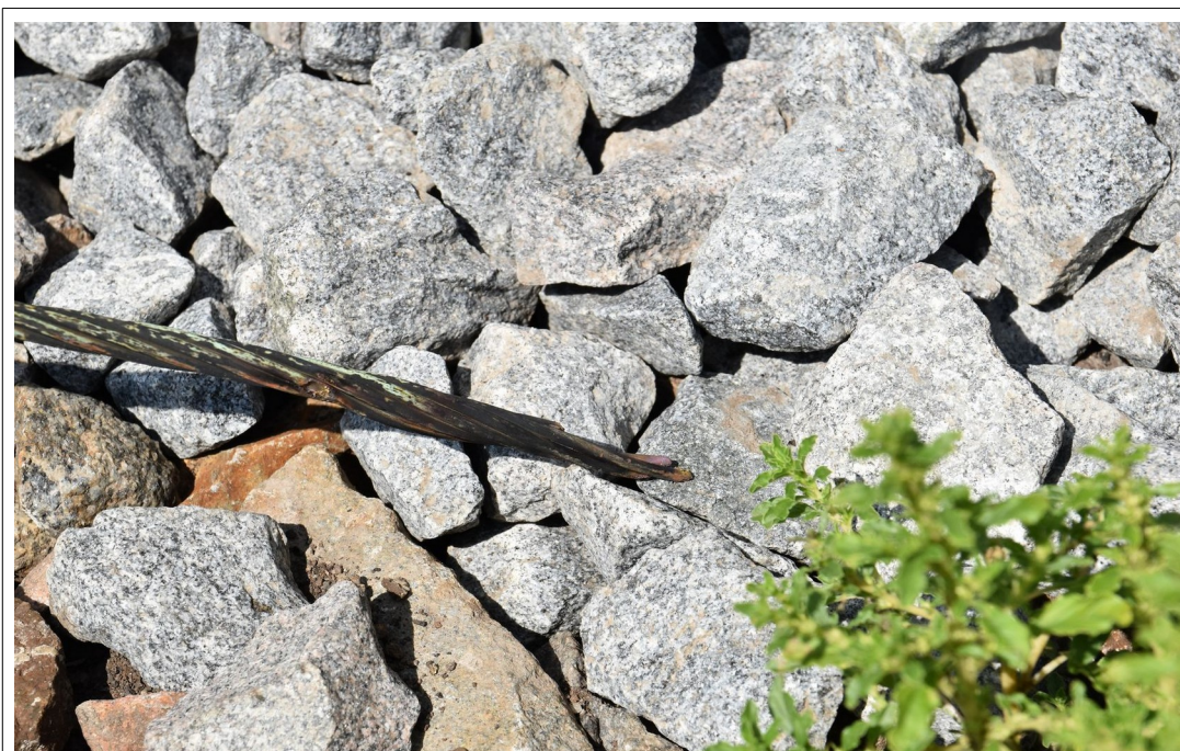
Obr. č. 10: Pohled na konec přepáleného nosného lana TV
