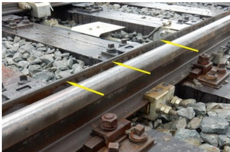
Obr. č. 7: Stopy po otěru kol DV na jazyku výhybky č. 253
