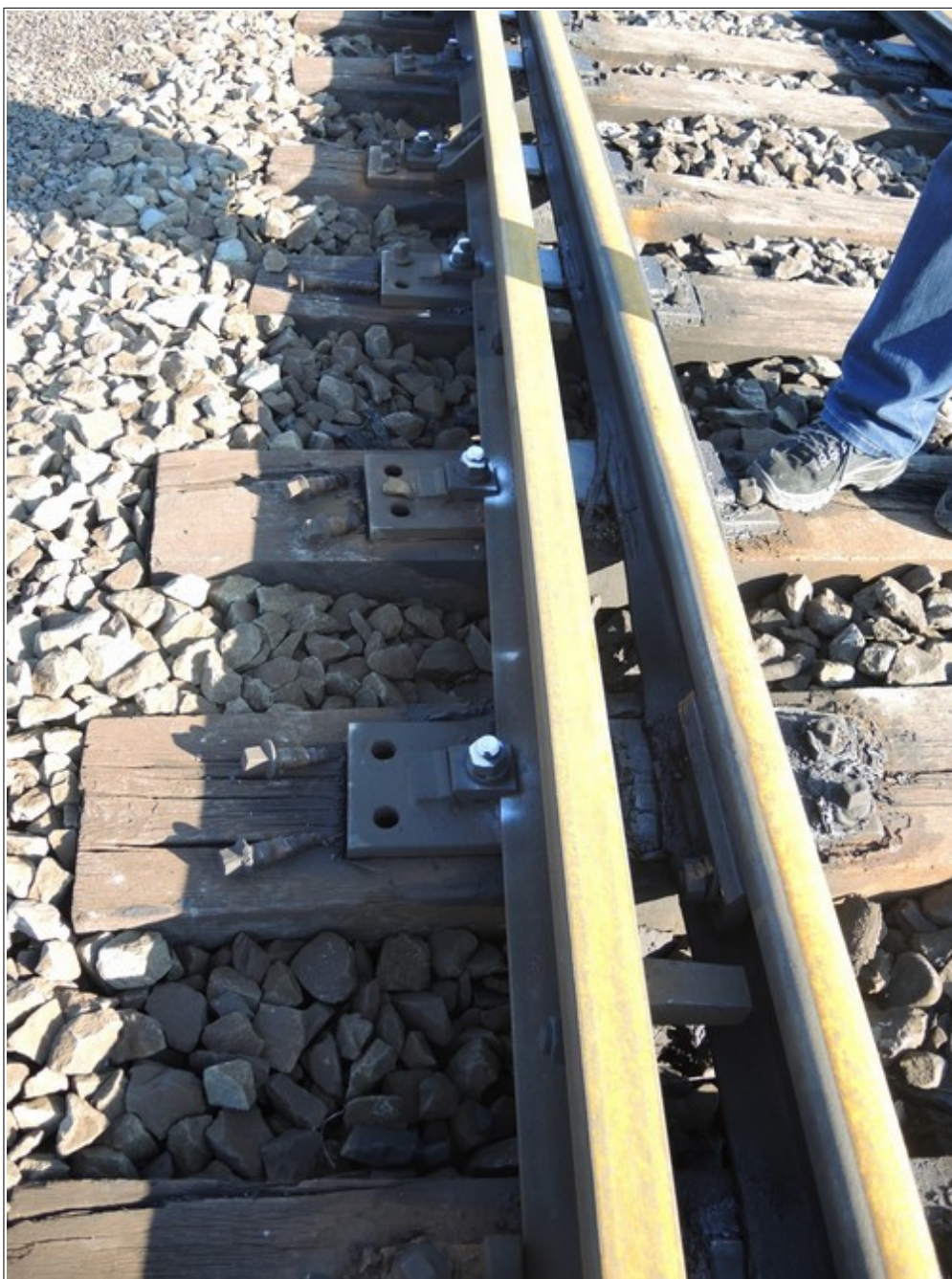
Obr. č. 13: Pohled na upevňovadla v místě pravého ohnutého jazyka výhybky č. 213, vč. silně korozí poškozených a zlomených vrtulí po jejich vytažení pouze rukou, a to bez použití drobné mechanizace.
