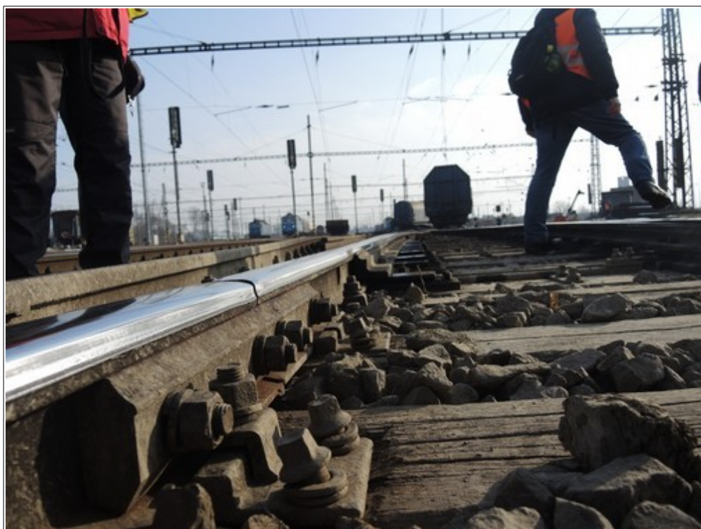
Obr. č. 9: Pohled na stav upevňovadel (vrtulí) v místě lomu svaru na styku KV č. 209 a ZV č. 213 v levém kolejnicovém pásu. Zdroj: DI
