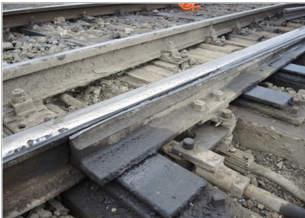
Obr. č. 11: Bod „0“ – hrot levého jazyka výhybky č. 213, vada na pojížděné hraně hlavy levé opornice a vydrolení levého jazyka výhybky č. 213. Zdroj: DI
