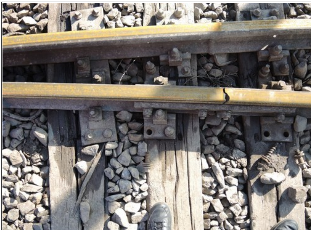
Obr. č. 10: Pohled na dřevěné prazce v místě lomu svaru na styku KV č. 209 a ZV č. 213 v levém kolejnicovém pásu, vč. upevnění podkladnic k prazcům a scházející upevňovadla, po vytažení 3 vrtulí pouze rukou. Zdroj: DI
