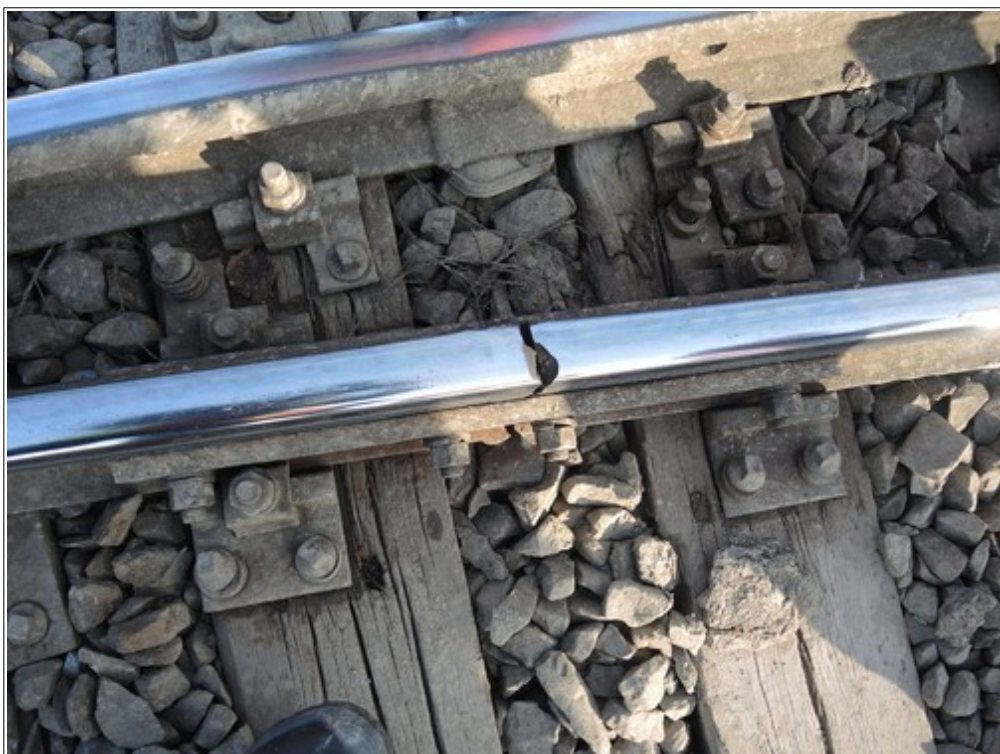
Obr. č. 8: Pohled na zaspojovaný lom svaru na styku KV č. 209 a ZV č. 213 v levém kolejnicovém pásu. Zdroj: DI
