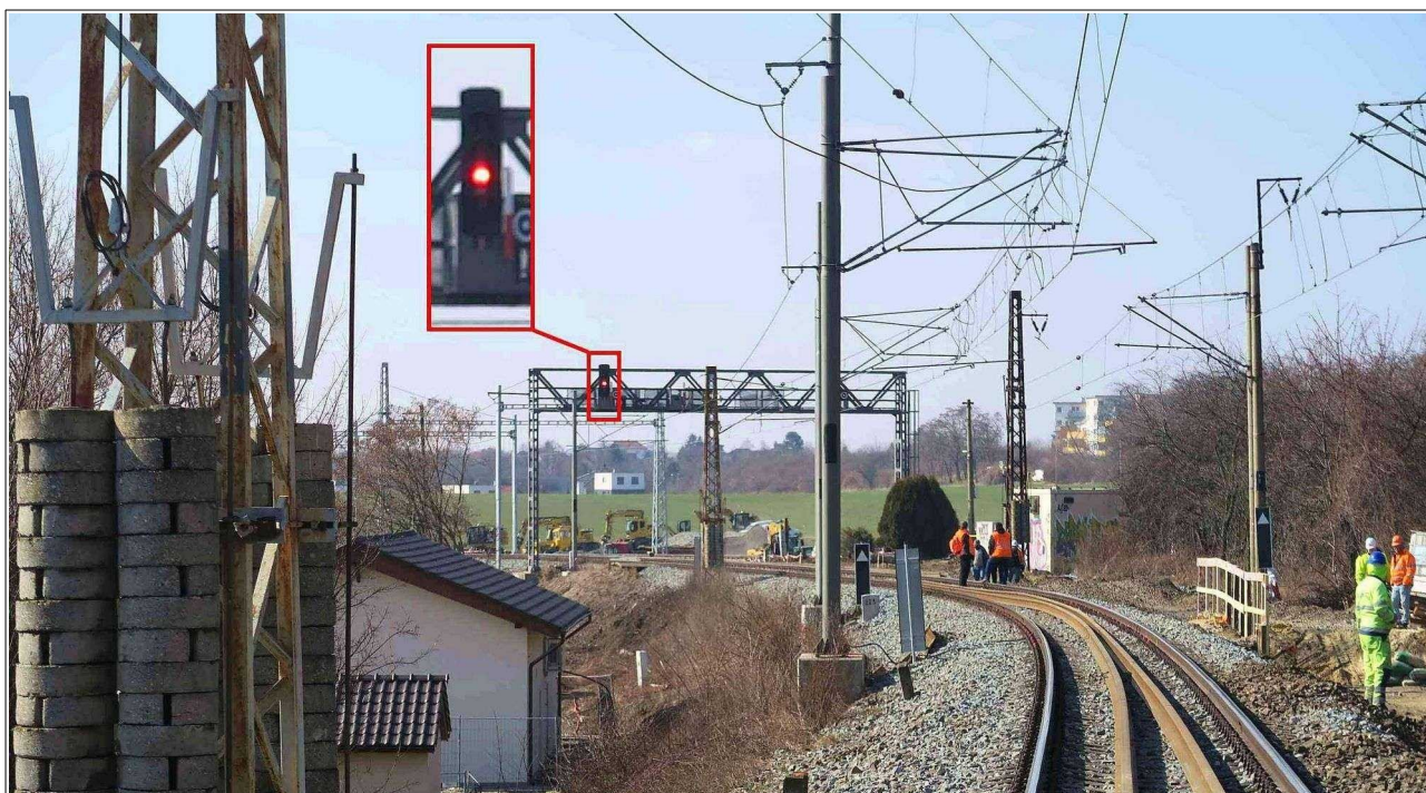
Obr. č. 8: Pohled na návěštní lávku s vjezdovým návěstidlem 1L Odbočky Skály ze směru jízdy vlaku Nex 60204 Zdroj: DI
