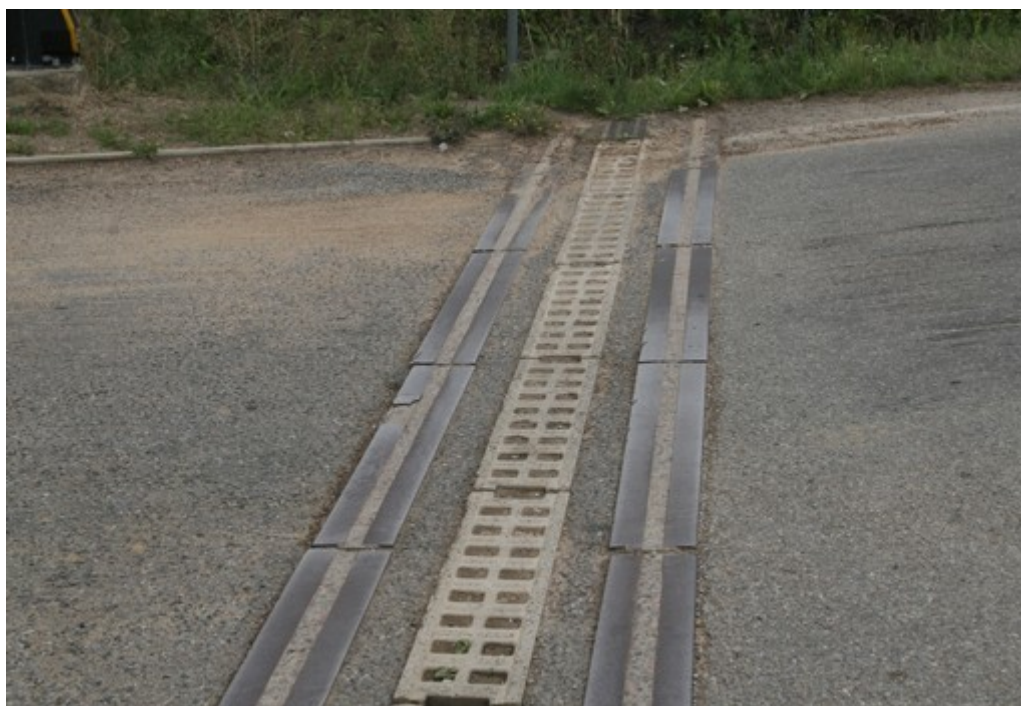
Obr. č. 4: Zanesené odvodňovací zařízení na železničním přejezdu P3652 Zdroj: DI
