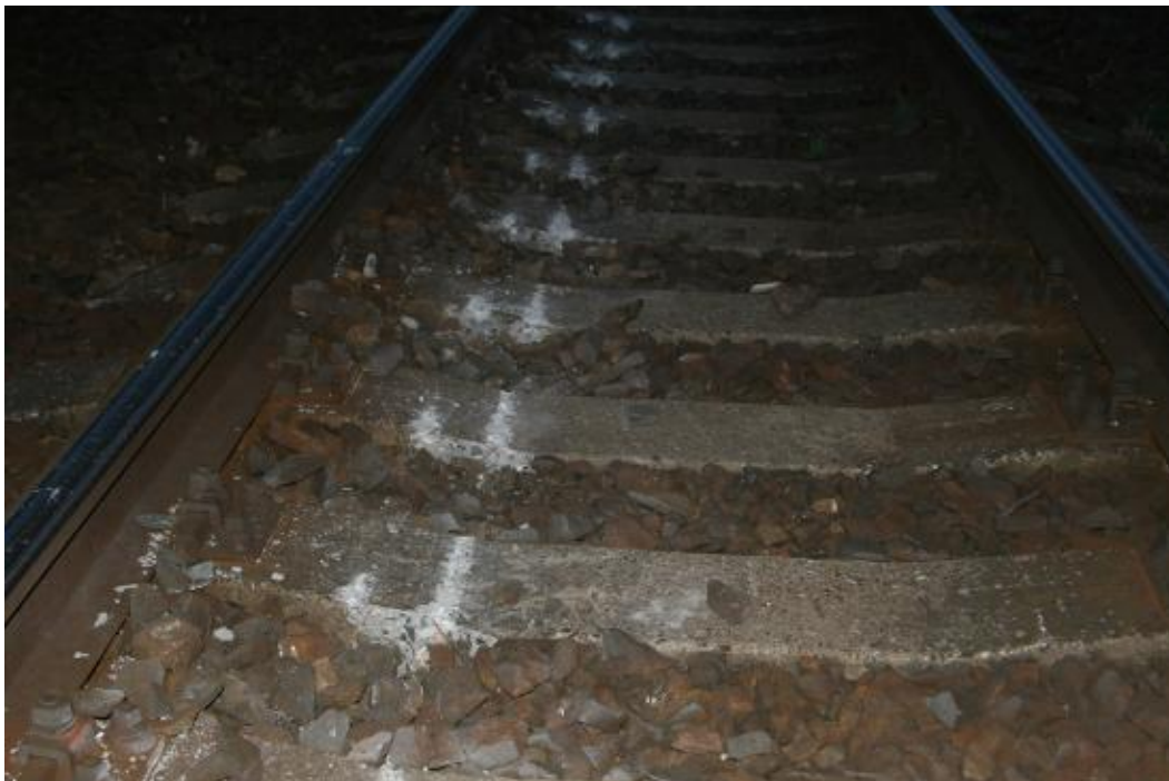
Obr. č. 10: Stopy po vykolejení na svršku v žst. Liběchov
