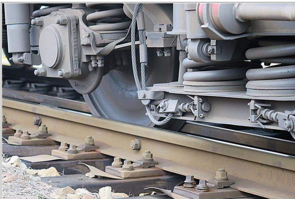
Obr. č. 3: Propad pravého kola 4 dvojkolí řídicího vozu mezi jazyk a opornici výhybky č.12 (vlak se pohyboval zleva doprava).
