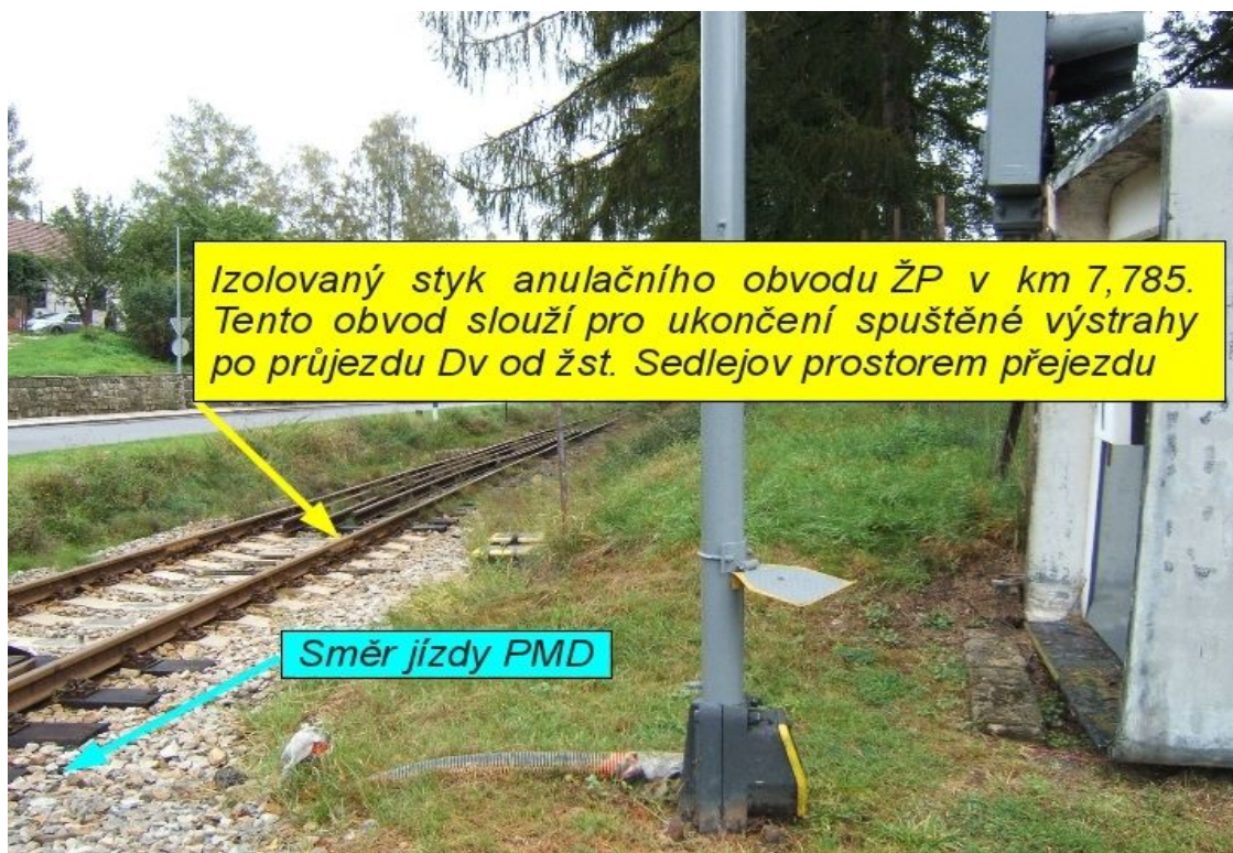
Foto 4: Izolovaný styk anulačního obvodu přejezdu
