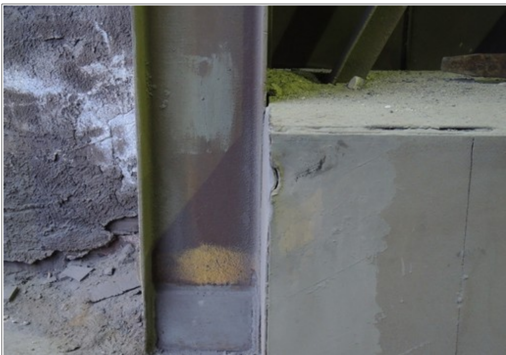
Obr. č. 8: Stopa po otěru na oplechování boční zídky levé rampy v hale ÚLD. Zdroj: DI
