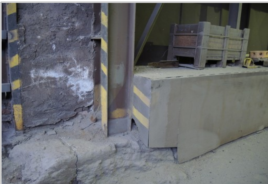
Obr. č. 7: Prostor za rolovacími vraty v hale ÚLD. V popředí patka stožáru nosníku a pevná nerovnoměrná terénní nerovnost neoznačená bezpečnostními značkami. Na oplechování boční zídky rampy viditelná stopa po otěru. Zdroj: DI
