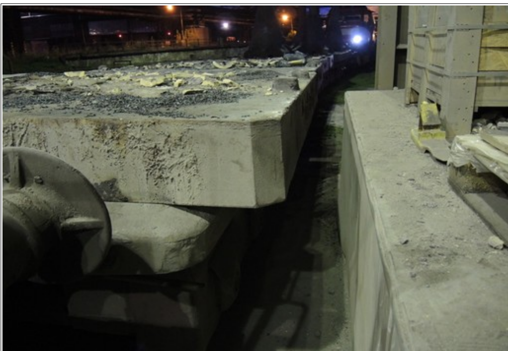
Obr. č. 6: Mezera mezi levou boční stranou licí desky a stěnou zídky levé rampy v hale ÚLD. Zdroj: DI
