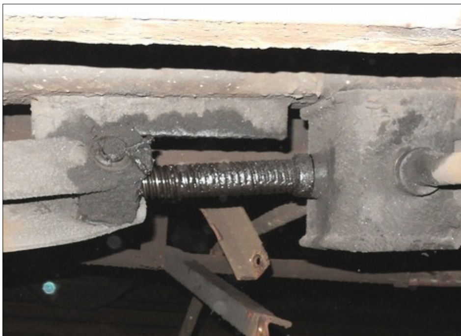
Obr. č. 4: Pohled na vřeteno pořádací brzdy TDV 81 54 5972 878-9 se zřetelně setřeným mazacím tukem.
