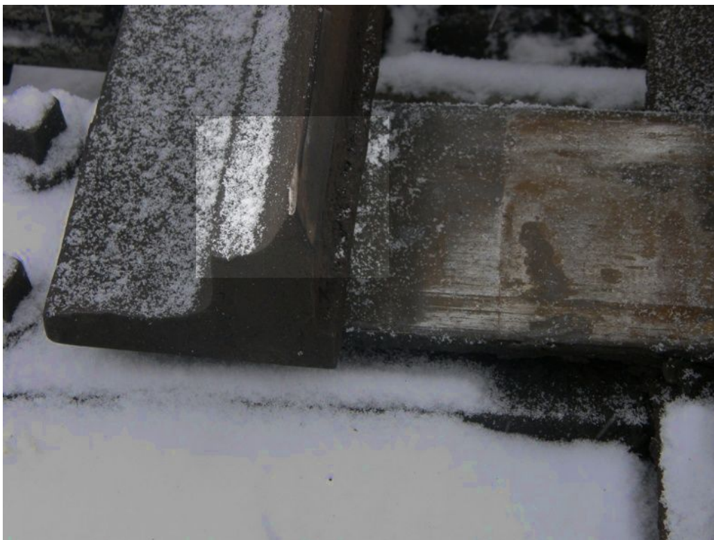
Obr. č. 3: Naražený hrot jazyka výhybky a nenamazaná kluzná stolička Zdroj: SŽDC
