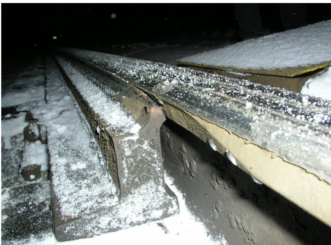
3. Pohled na komisionálně stanovený bod "0" - první stopa po vykolejení HDV řady 742.126-6 na výhybce č 15 žst. Bystřice nad Olší v km 305,520 trati Mosty u Jablunkova st. hr - Bohumín. Naražený hrot pravého ohnutého jazyka po odtažení nevykolejených TDV
