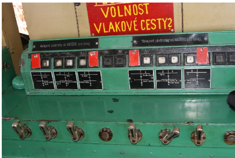
Foto 4: Kolejové závěrníky St 2 žst. Čelákovice
