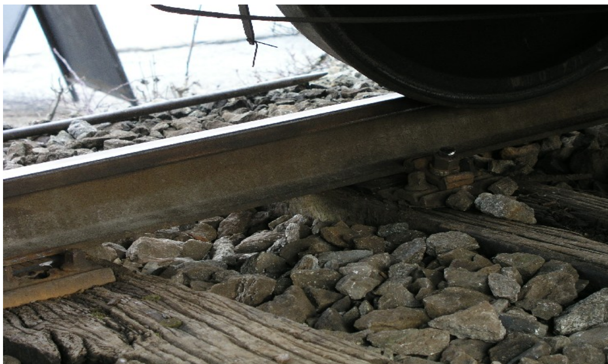
Foto 3: Chybějící upevňovadla na levém kolejnicovém pásu
