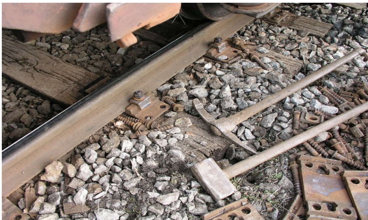
Foto 4: Chybějící upevňovadla v místě vykolejení na pravém kolejnicovém pásu
