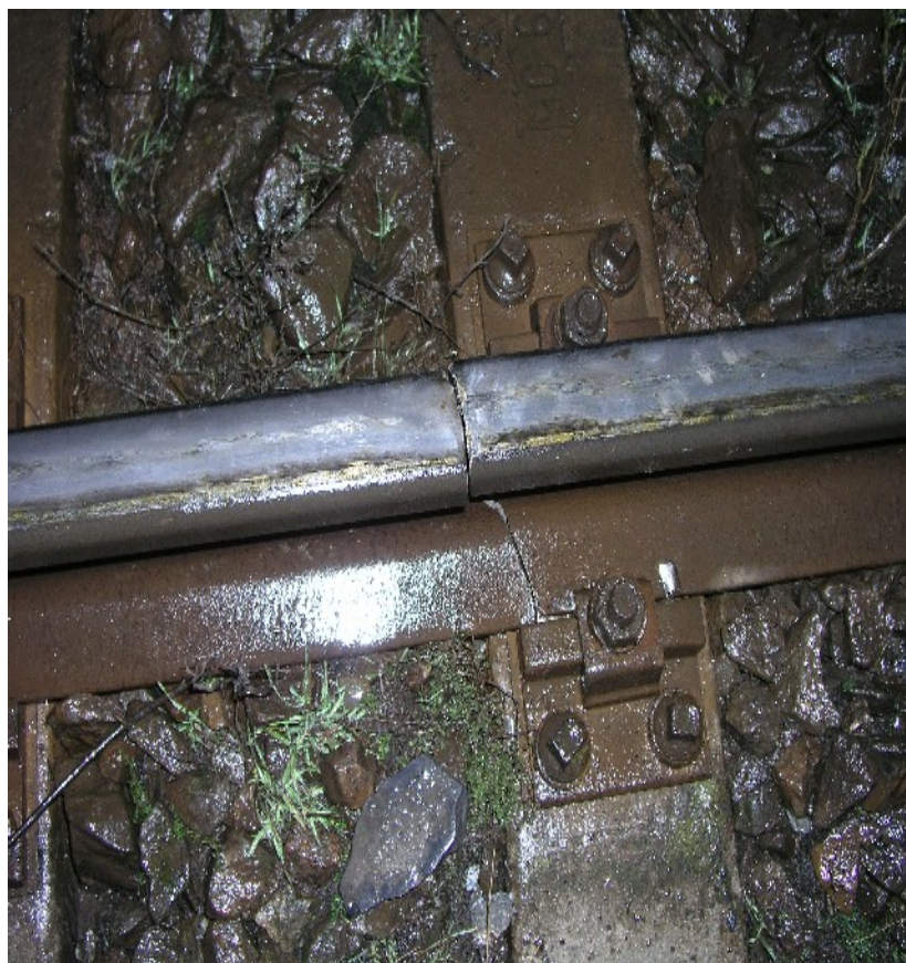
Foto 3: První lom kolejnice
