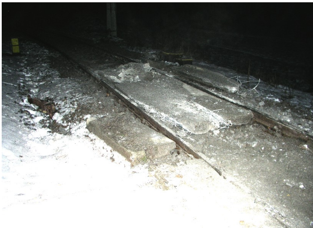
Foto 11: poškozený přejezd v km 250,851
