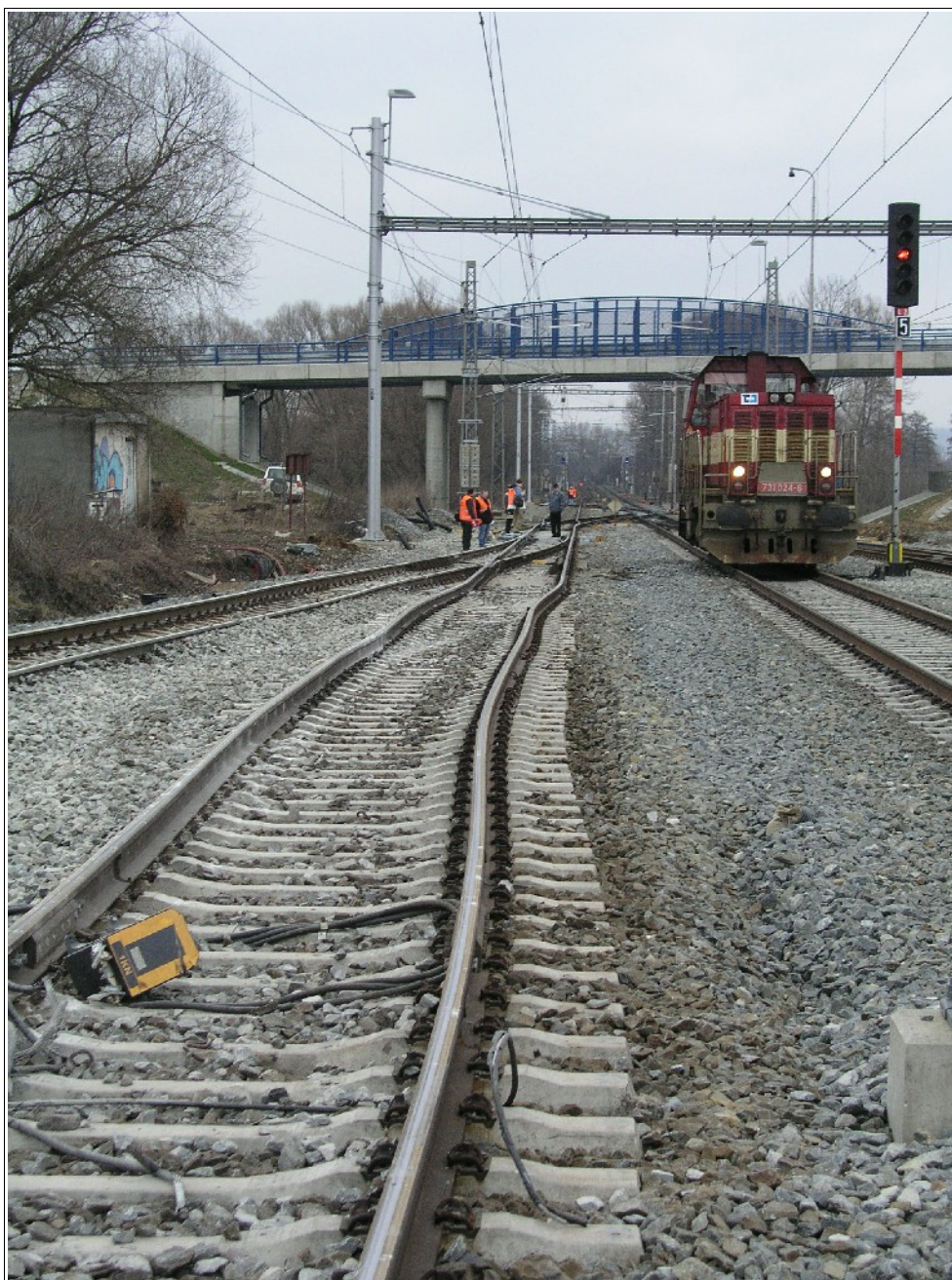
Foto 3: Pohled na poškozenou staniční kolej č. 1 v žst. Lukavice na Moravě
