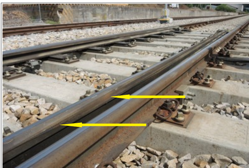
Obr. č. 6: Stopy po otěru kol DV na ohnutém jazyku výhybky č. 6
